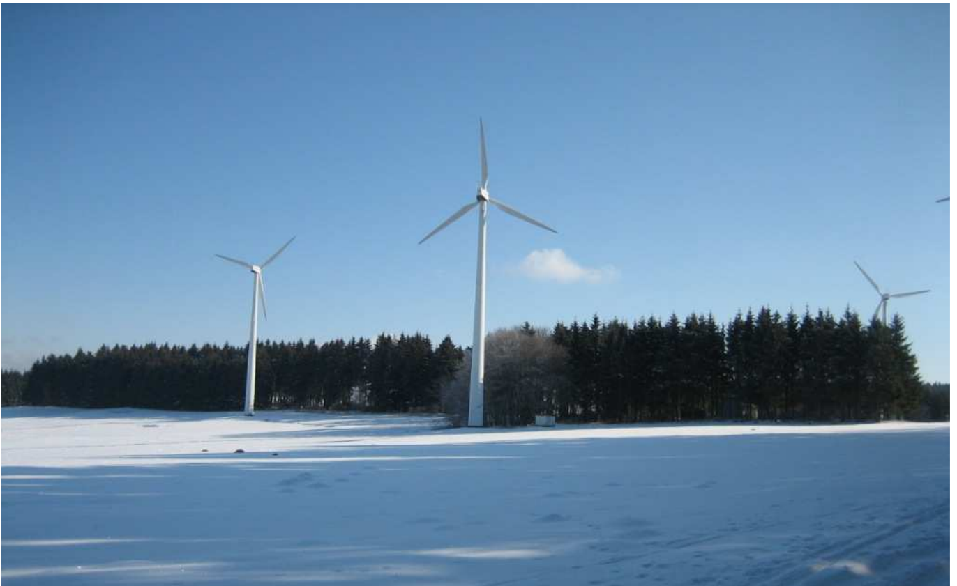
Diese Windräder am Nordhang der Fuchskaute müssen Sturm und Kälte trotzen.
